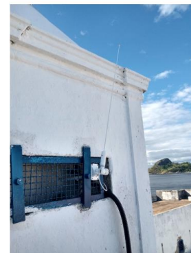
Antena AIS Ftz Sta Cruz
