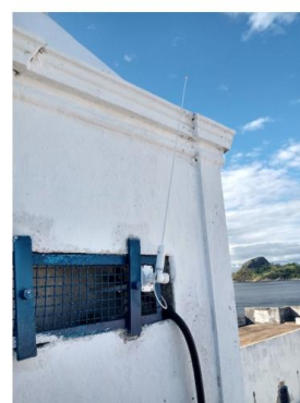
Antena AIS Ftz Sta Cruz
